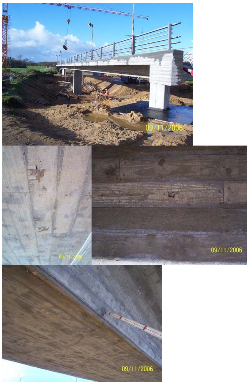
Figur 3-13: Eksempler på støbefejl på brounderside.
