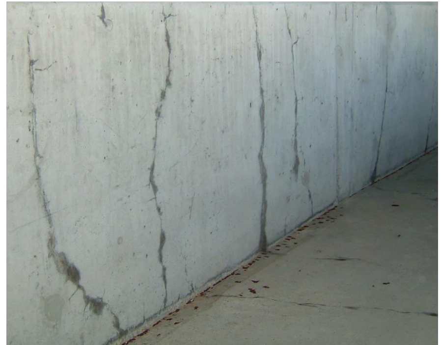
Termiske revner i væg støbt på eksisterende konstruktion
