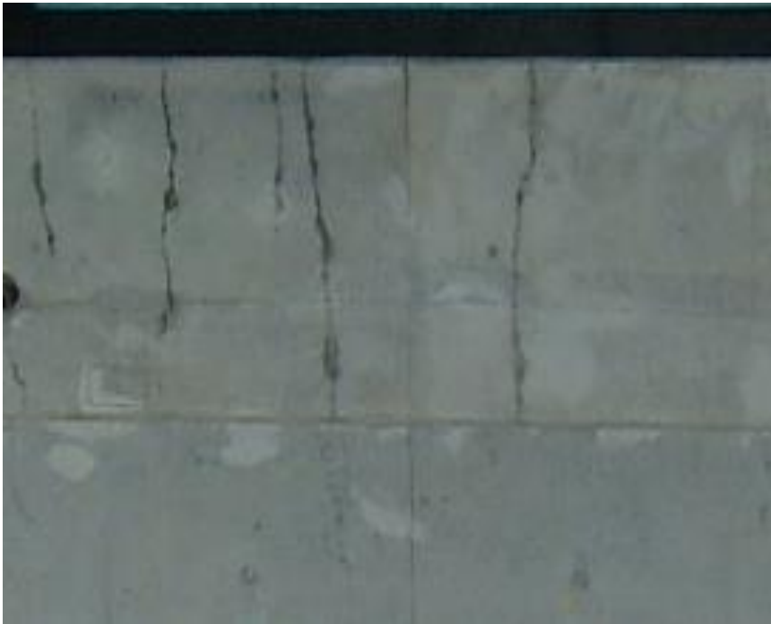
Termiske revner i toppen af fastholdt væg
